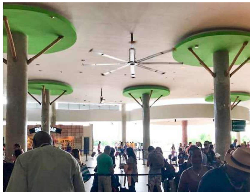
Aérogare de Punta Cana (Rép. Dominicaine) : BAP montés trop hauts.
